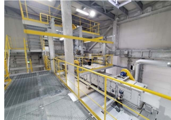
③灰出し設備室
