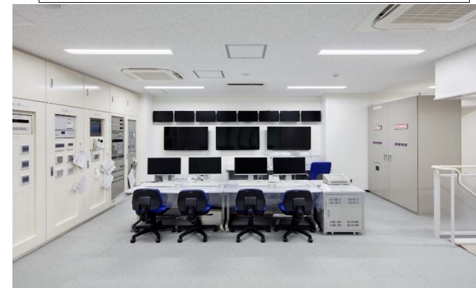
写真⑤ 中央制御室
