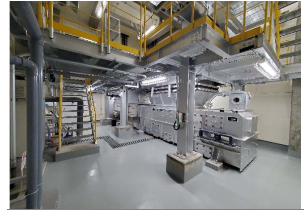
②破碎選別機室
