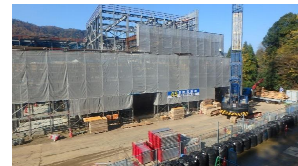
写真③ プラットホーム・リサイクルエリア(南東から)
